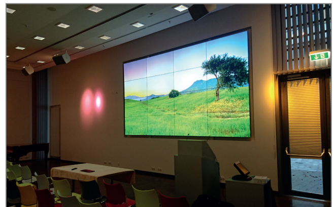
Installationsbeispiel Johannes Wesling Klinikum, Minden
